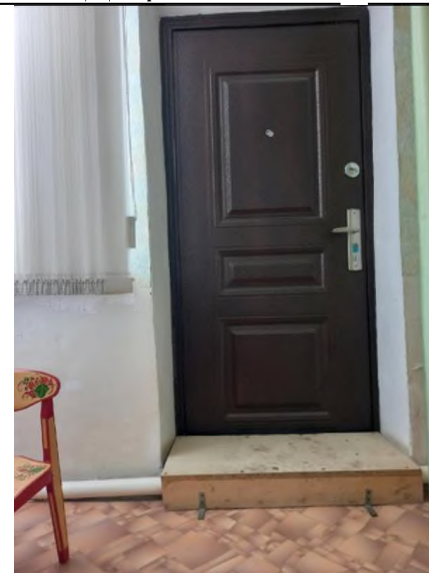
Фото №14 Дверь запасного выхода № 8
