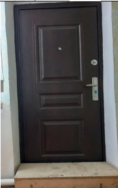
Фото №15 Дверь запасного выхода № 7
